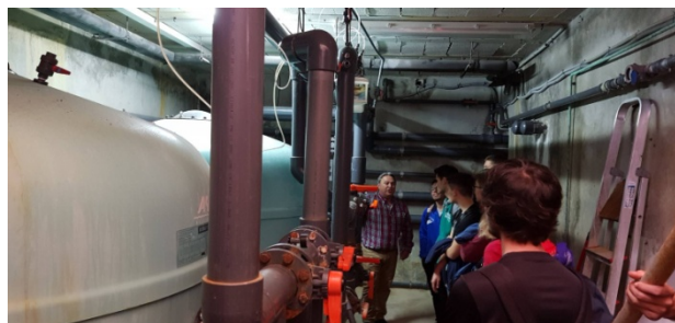
Figura 47. Visita guiada a la sala de calderas del Complejo Deportivo UCA en Puerto Real.
