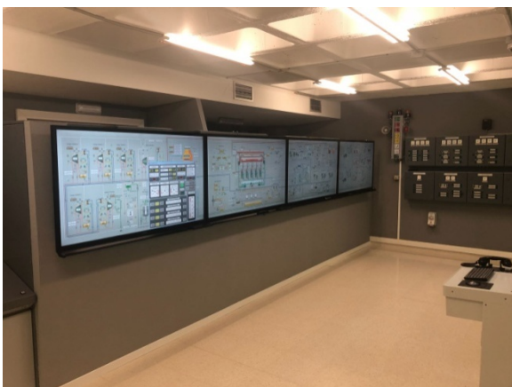
Figura 3. Cámara de Máquinas
